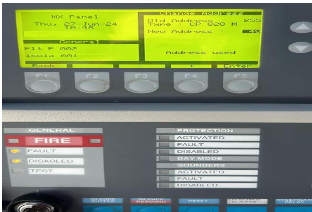
Рис. 1. Система пожарной сигнализации “Minerva T-2000” (27.01.2024, фото с судна “Ханкенди”).
